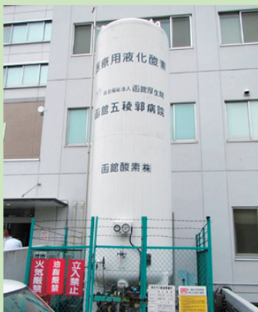
液化酸素貯蔵タンク
