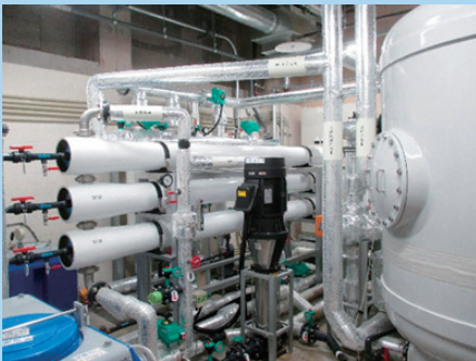
井水ろ過装置
