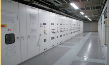
▶ 電力供給設備
