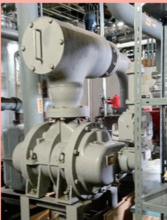
都市ガス設備
